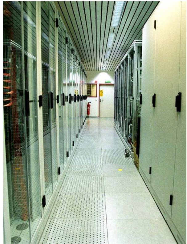
Nätverksutrustningsrummet vid Columbuskontrollcentret. (Bild: ESA)
